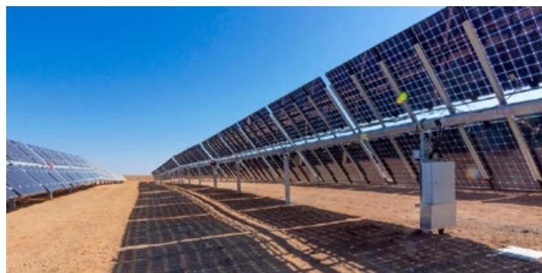
Figura 3. Paneles solares fotovoltaicos (Fuente: Getty imagen).
